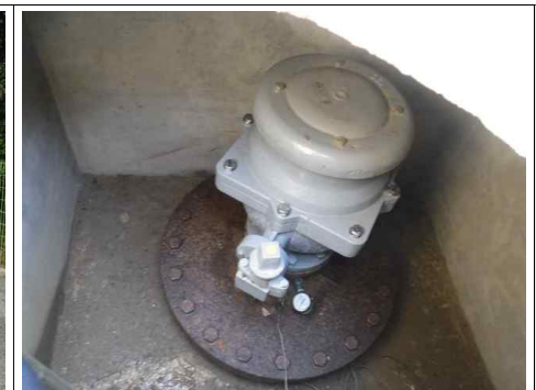
밸브실 내부 전경
