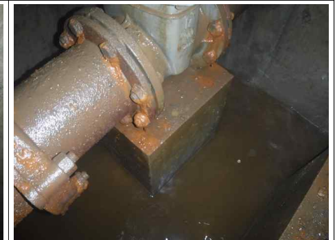
밸브 받침콘크리트 상태
