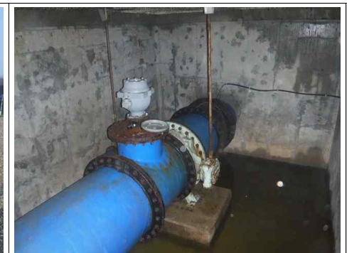
밸브실 내부 전경
