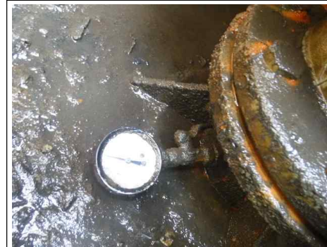
수압계 작동상태 양호
