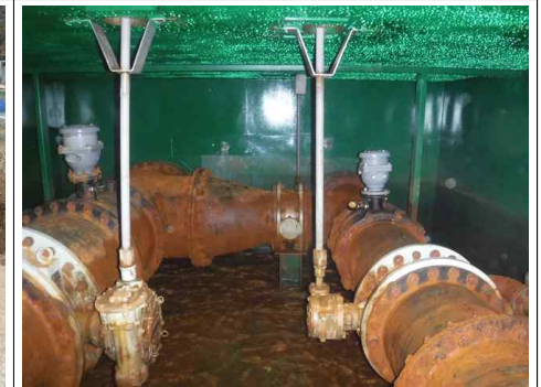
밸브실 내부 전경
