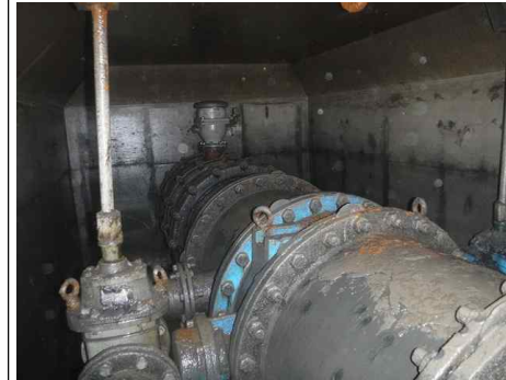
배관 및 밸브 상태
