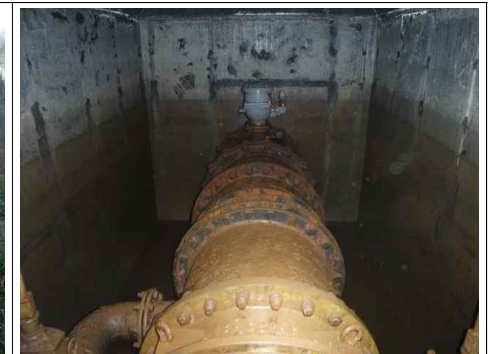
밸브실 내부 전경
