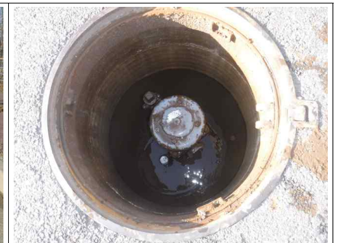
밸브실 내부 전경
