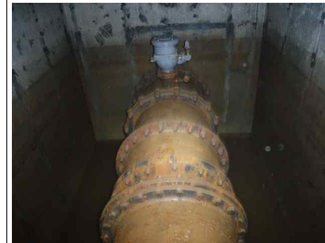
배관 및 밸브 상태
