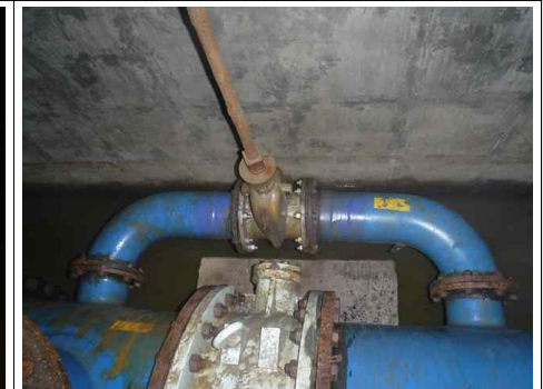
밸브 받침콘크리트 상태
