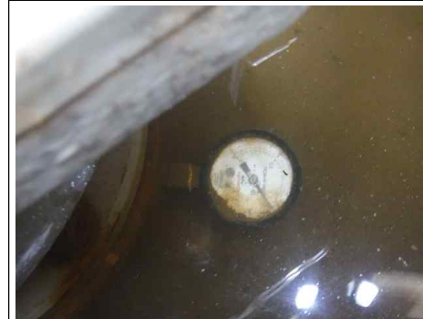
수압계 작동상태 양호
