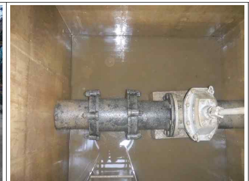
밸브실 내부 전경
