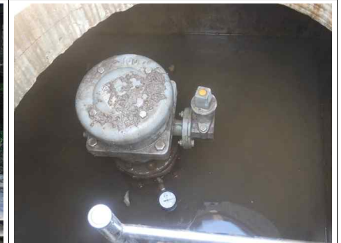
밸브실 내부 전경
