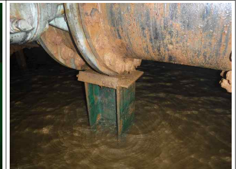
밸브 받침콘크리트 상태
