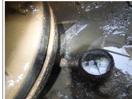
수압계 작동상태 양호
