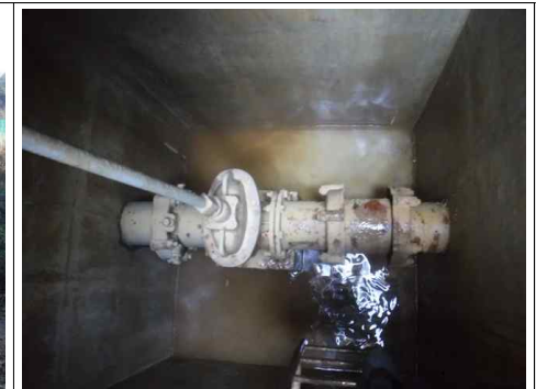
밸브실 내부 전경
