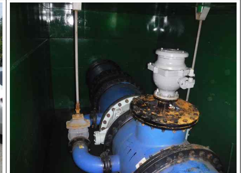
밸브실 내부 전경
