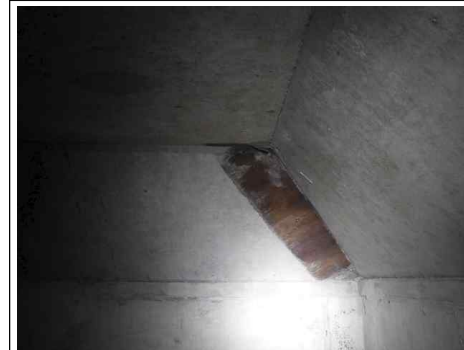
상부슬래브 거푸집 미제거
