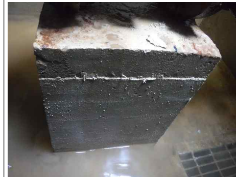
밸브 받침콘크리트 상태
