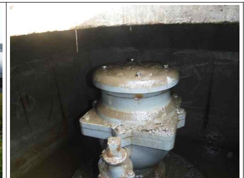
밸브실 내부 전경
