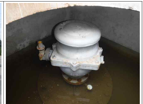
밸브실 내부 전경
