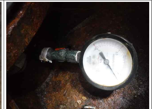
수압계 작동상태 양호
