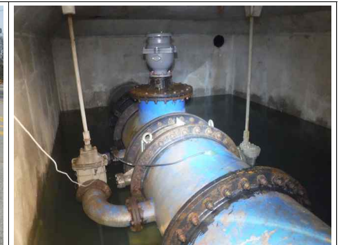
밸브실 내부 전경
