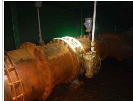
배관 및 밸브 상태
