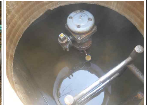
밸브실 내부 전경
