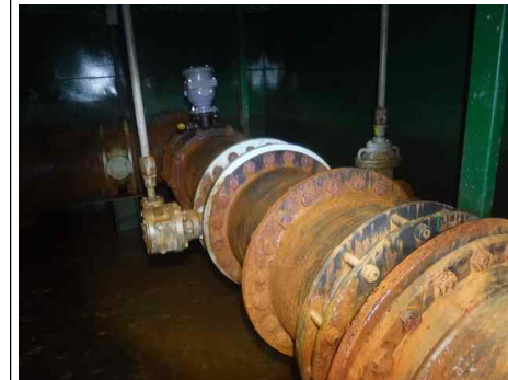
배관 및 밸브 상태
