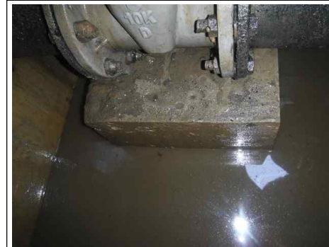
밸브 받침콘크리트 상태
