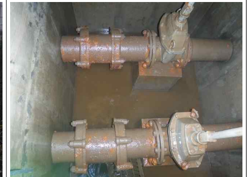
밸브실 내부 전경
