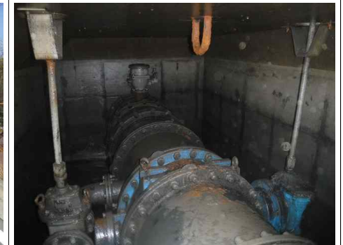
밸브실 내부 전경
