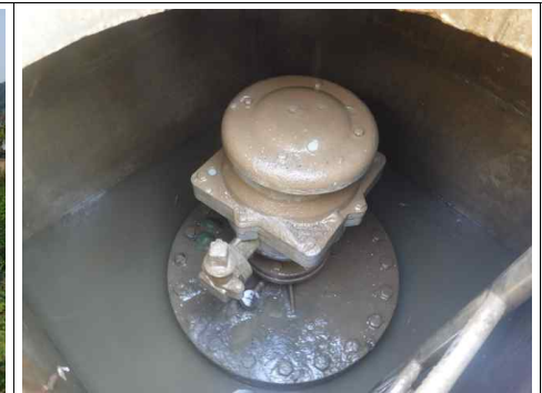
밸브실 내부 전경
