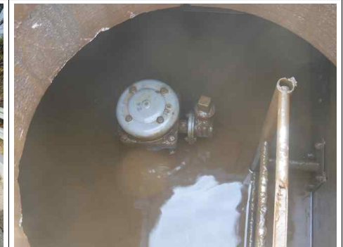
밸브실 내부 전경
