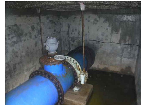
배관 및 밸브 상태
