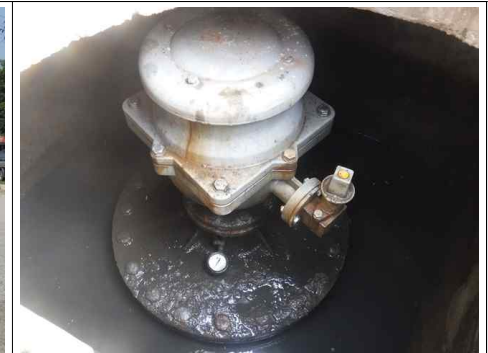
밸브실 내부 전경
