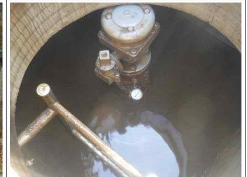
밸브실 내부 전경
