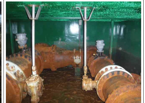
밸브실 내부 전경
