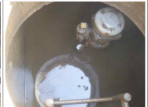
밸브실 내부 전경
